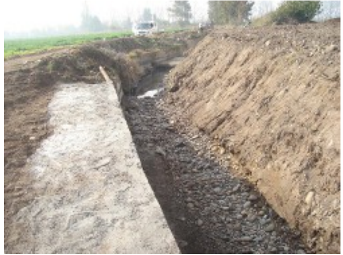
Gabión en borde de canal Unificado, sector Lo Carvallo. Construcción realizada para evitar y contener socavación de borde derechos aguas abajo, como resultado de la velocidad de flujo en el sector.
