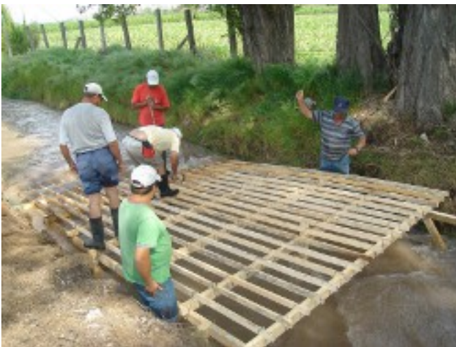
Construcción y ubicación rejas contenedoras de basura en canal Santa Ana.
