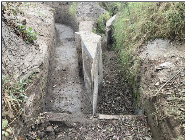
Reparación marco partidor interior Lo Moya-Nueva Independencia M078-3, comuna Calera de Tango.
