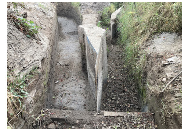
Reparación marco partidor interior Lo Moya-Nueva Independencia M078-3, comuna Calera de Tango.
