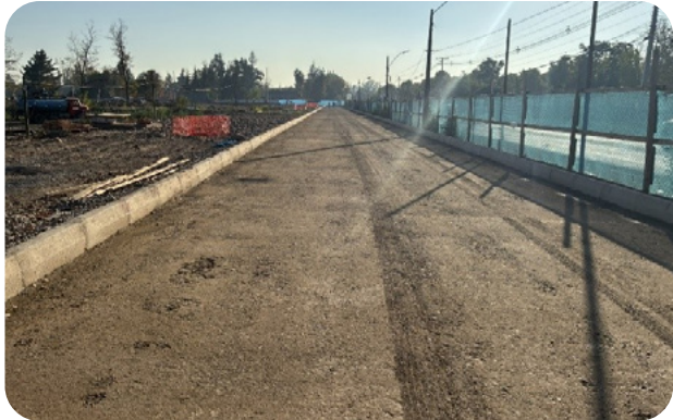
Canal El Manzano entubado bajo camino Lonquén
